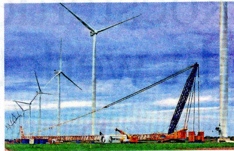
Windpark Wieringermeer in aanbouw, het grootste molenpark van Nederland op land. De bijna honderd molens zijn goed voor een miljard kilowattuur aan stroom.
